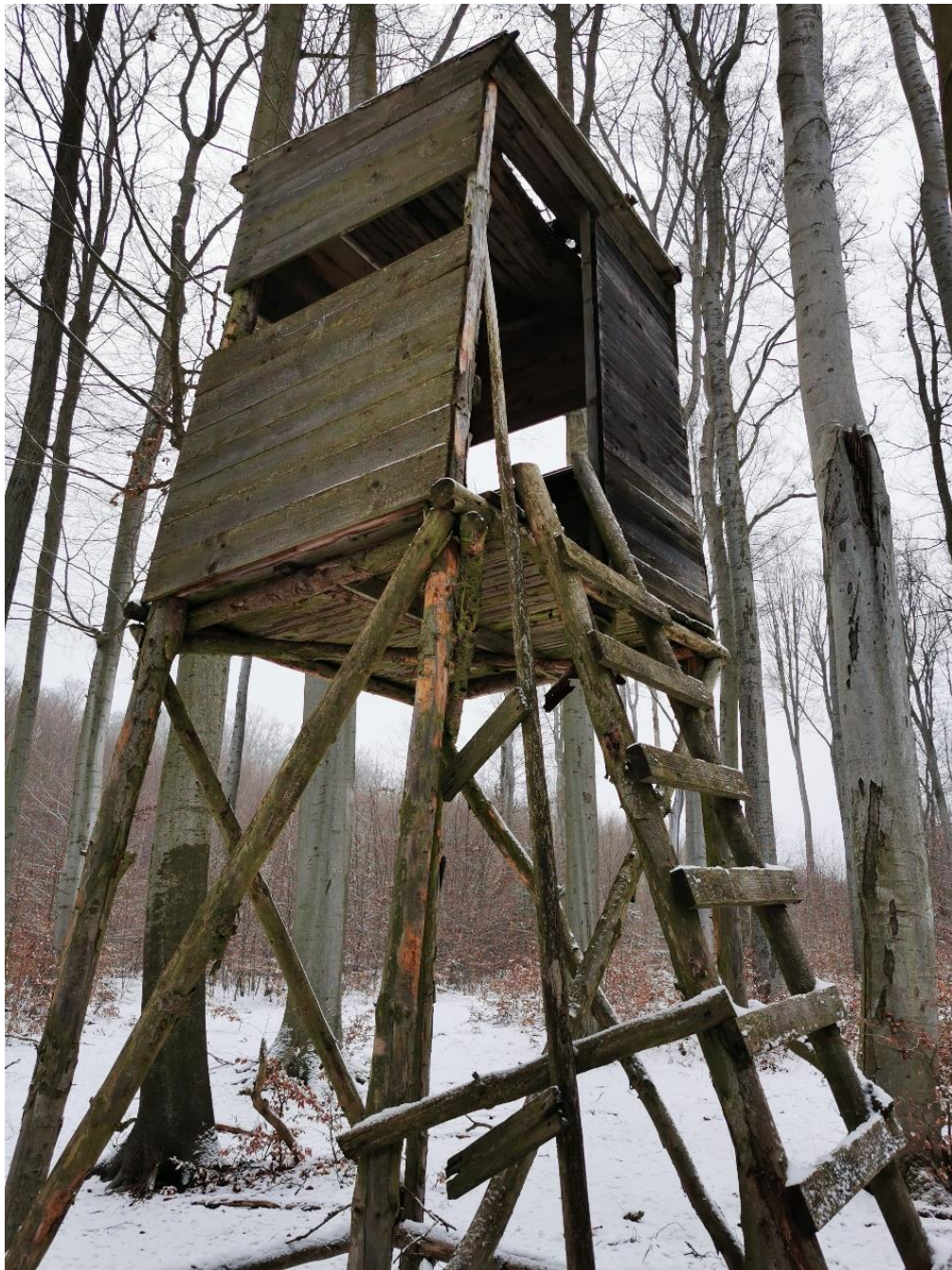
Obrázek 32: Poškozená Kazatelna 4 Zdroj: vlastní
