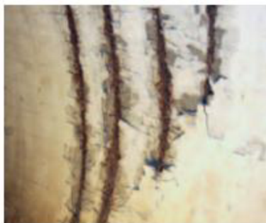
Obr. č. 9 : Lokální defekt betonu a zkorodovaná výztuž v kanalizaci [26]
