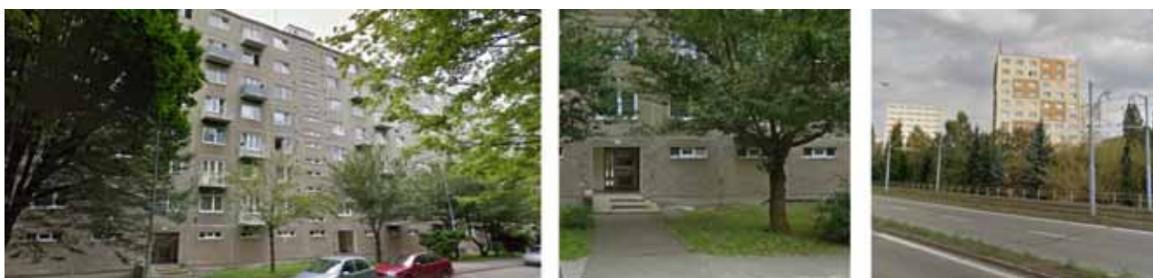
Obr. 54 Sídlíště Černá Pole: bytový dům B60, původní fasáda – podoba vstupu do obytného domu z nám. SNP – „regenerované“ věžové domy z třídy Generála Píky, s úpravou fasády nerespektující tektoniku domu 274
