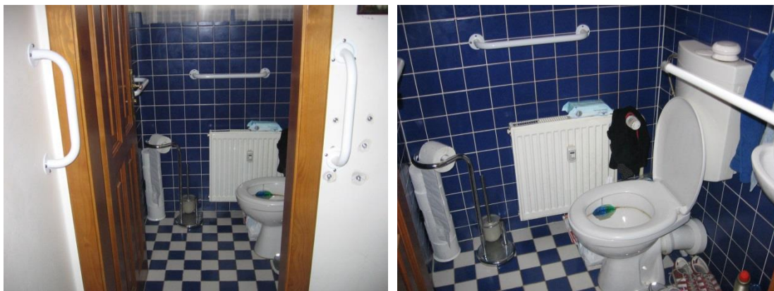
Facilitátor pro mobilitu a přesun - systém madel, který jedné z pacientek/klientek dopomáhá k přesunu a sebeobsluze na WC.
