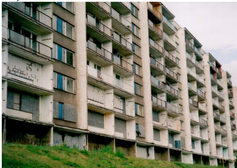
Obr. 15: Zapečetěný panel. dům (135 bytů) v Gluckově ulici.
