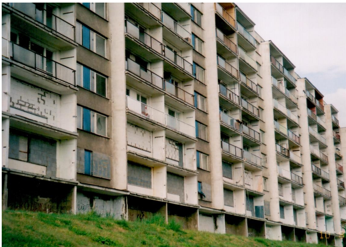
Obr. 63: Zapečetěný panelový dům o devíti vchodech (135 bytů) v Gluckově ulici. Vstupy do objektu a okna do výše 2. nadzemního patra jsou zazděny. Balkonová zábradlí ve spodních podlažích jsou preventivně odstraněna. Zdroj: V. T. Zoubková
