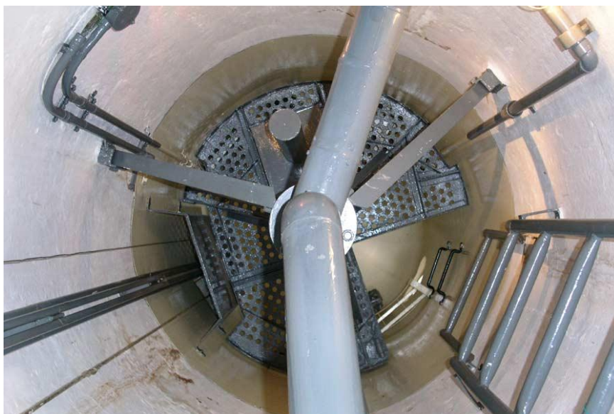
Obr. 114 – pohled zespod na podlážku pěchotního zvonu, žebřík, odvod vystřílených nábojnic a muniční výtah, muzeum NS – 82 „Březinka“, současný stav, archiv J. Hrubeckého
