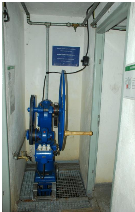
Obr. 119 – vodní čerpadlo Buldog na studnou pěchotního srubu, muzeum KS – 5, současný stav, archiv J. Hrubeckého
