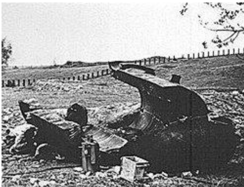
Obr. 125 – vytržený zvon pro lehký kulomet vchodového objektu KS – 12a tvrže Hůrka, během „těžby“ n. p. Kovošrot, 1956, archiv J. Hrubického
