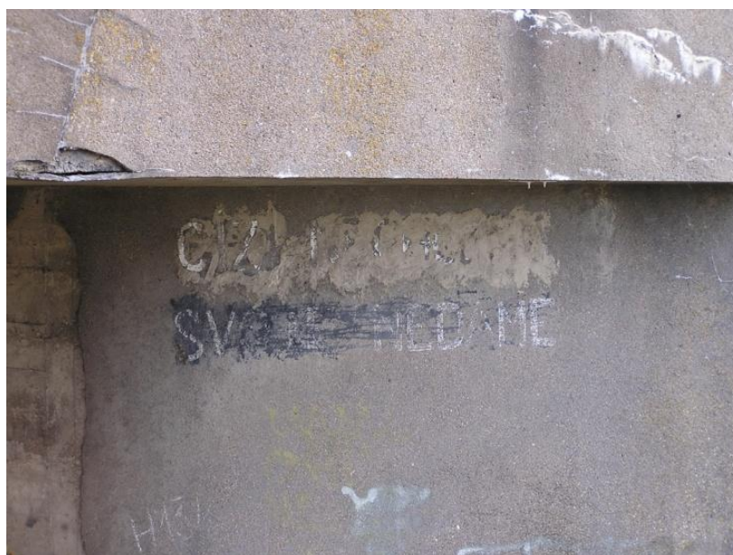
Obr. 79 – částečně dochovaný původní nápis „Cizího nechceme, svoje nedáme“ na objektu KS – 36, současný stav, archiv J. Hrubeckého
