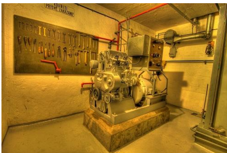
Obr. 121 – vybavená strojovna pěkhotního sruhu s dieselagregátem Škoda 3F8, muzeum NS – 82 „Březinka“, současný stav, archiv J. Hrubeckého
