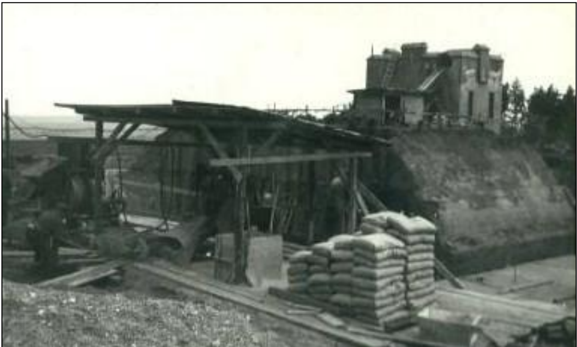
Příloha 10: Budování vodojemu na Stráži – 11.5 1950, stará armaturní komora s vodojemem (externí materiál Veolia, 2013)
