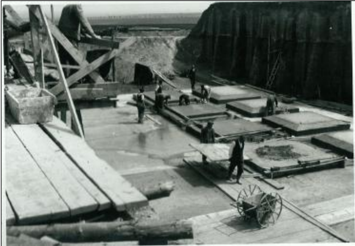
Příloha 9: Budování vodojemu na Stráži – 11.5 1950, I. nádrž - betonový podklad dna (externí materiál Veolia, 2013)
