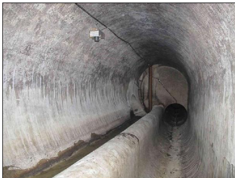
Obr. 26 Pohled do odlehovací komory Pavlovova.
