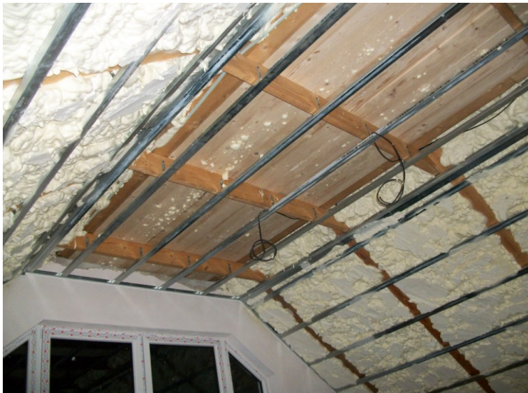
Obr. 1 Pohled na krokevní systém měřené části objektu, mezi jednotlivými krokvemi umístěná foukaná pěnová izolace
