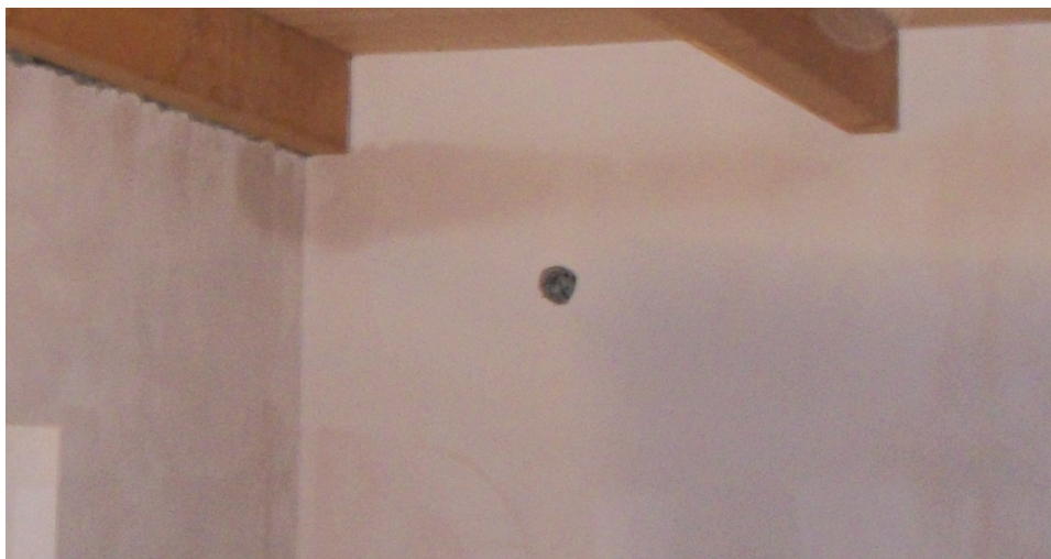
Obr. 11 Vlhký věnec u cihlové novostavby
