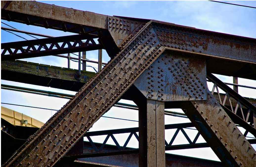
Obr. 4: Styčnickový plech připojený pomocí nýtů na Dundee Railroad bridge v Dundee Monroe v Michiganu [16].
