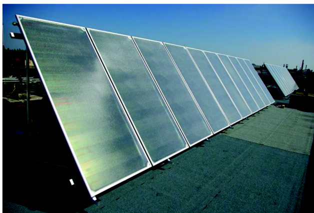
Obrázek 4 Sluneční kolektorový systém pro ohřev vody
