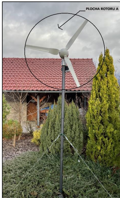
Obrázek 26 Malá větrná elektrárna
