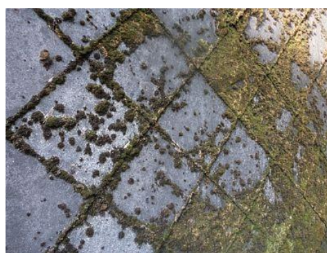
Obrázek č.26 – azbestocementová krytina pokrytá mechem (Archiv Nemopas, [online])
