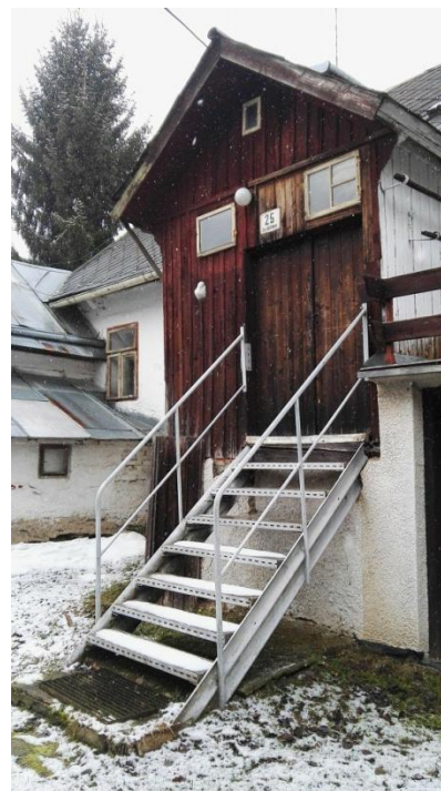
Obrázek č.41 – špatně provedená rekonstrukce (Pipková, 2018)
