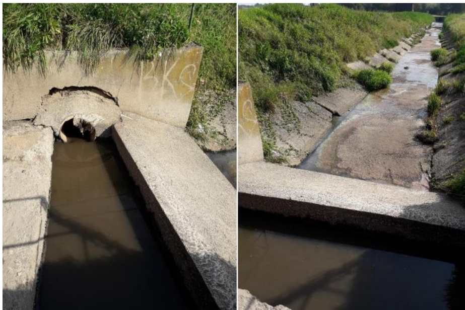
Obr. 2.9.1. Třeboň – odlehčovací komora (kanál) čistírny odpadních vod ústící do Spolského potoka (Duras, 2021)
