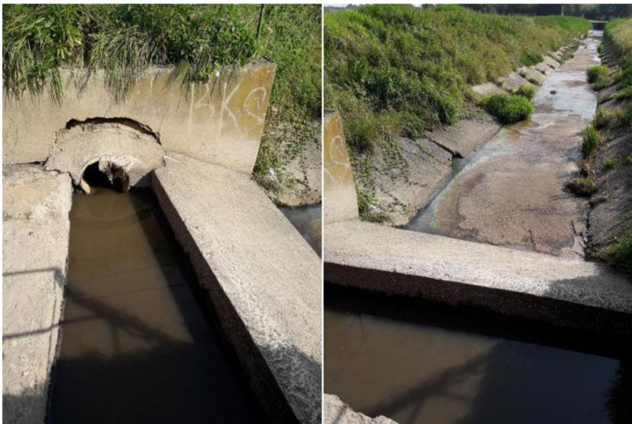
Obr. 2.9.1. Třeboň – odlehčovací komora (kanál) čistírny odpadních vod ústící do Spolského potoka (Duras, 2021)
