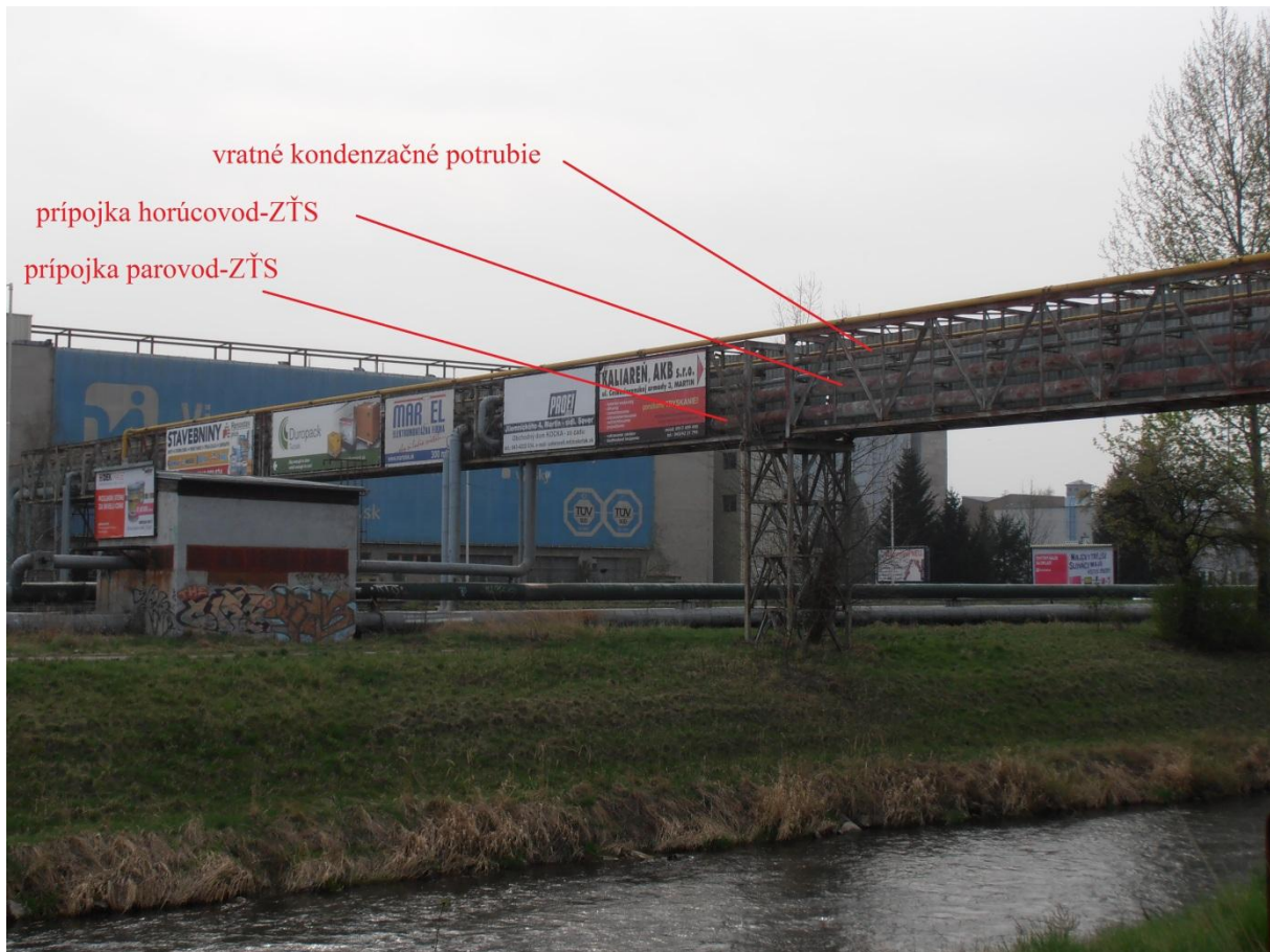
Obrázok 9- Prípojka parného rozvodu do areálu ZĽS
