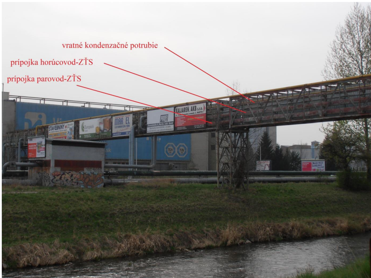
Obrázok 9- Prípojka parného rozvodu do areálu ZĽS
