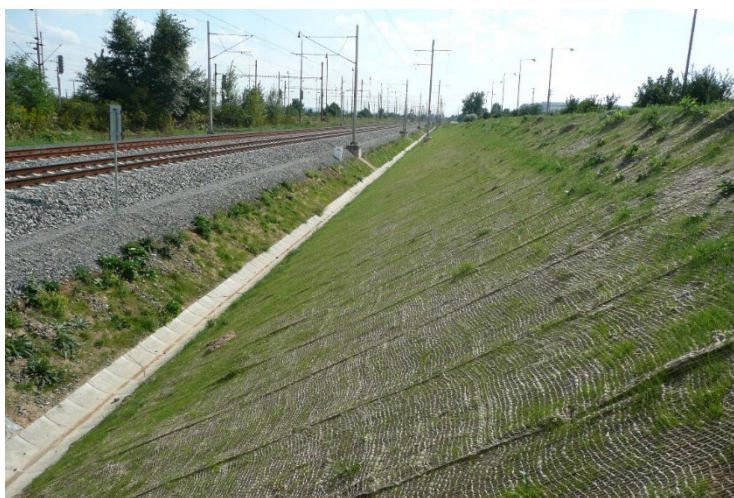
Obrázek 6 – Stav zářezového svahu železničního koridoru traťového úseku Modřice – Brno Horní Heršpice jeden rok po položení jutové geotextílie o plošné hmotnosti 500 g/m 2 (JUTA, 2022)
