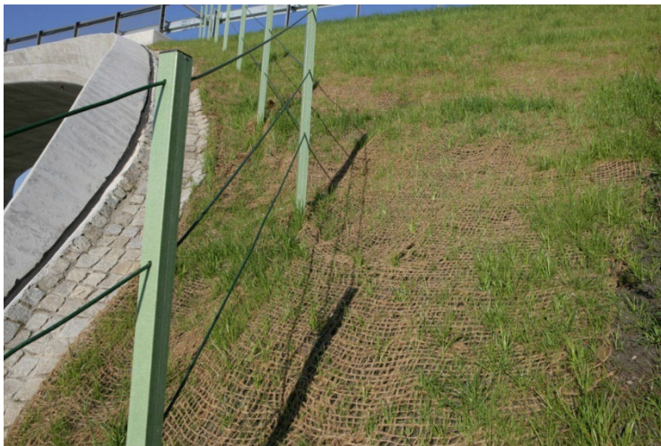
Obrázek 10 – Stav svahu mostu u dálnice jeden rok po položení kokosové geotextílie o plošné hmotnosti 400 g/m 2 (JUTA, 2022)
