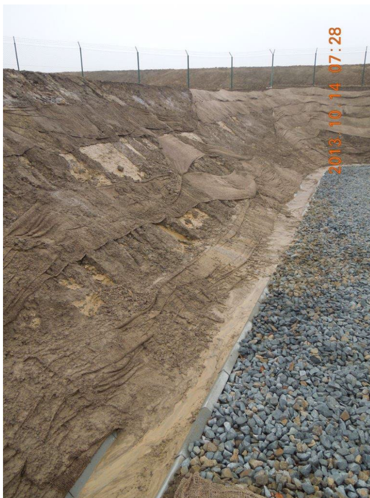
Obrázek 1 – Nevhodný směr pokládky a typ přírodního protierozního materiálu na zářezovém svahu (JUTA, 2013)
