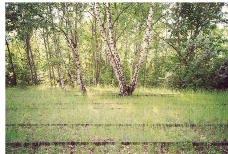
Obr.č. 50: Zarůstající kolejiště
