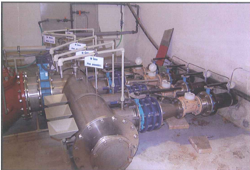
Obr. 19 - ÚV Ostrov svodné potrubí z jímacích objektů
