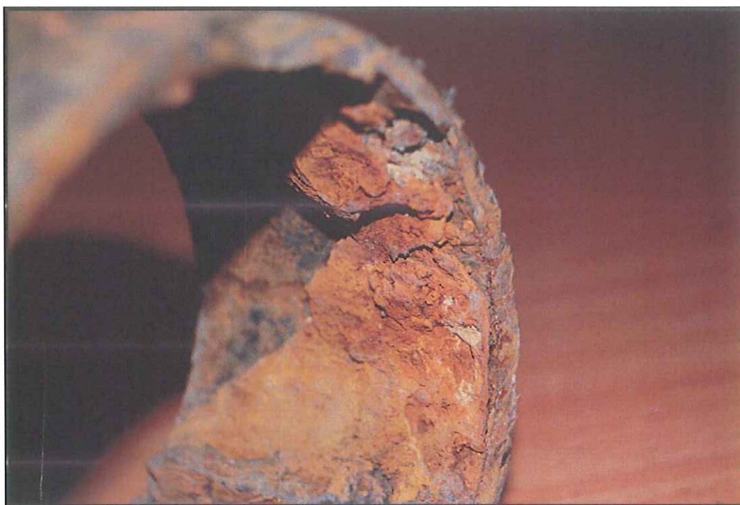
Obr. 18 - Detail snímku s patrnou korozi potrubí
