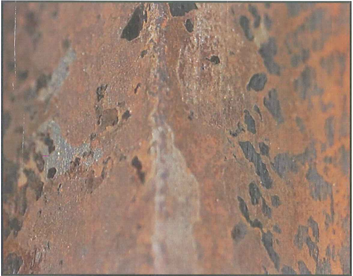
Obr. 32 - Detail tyče z VDJ Žďár po odstranění svrchní vrstvy
