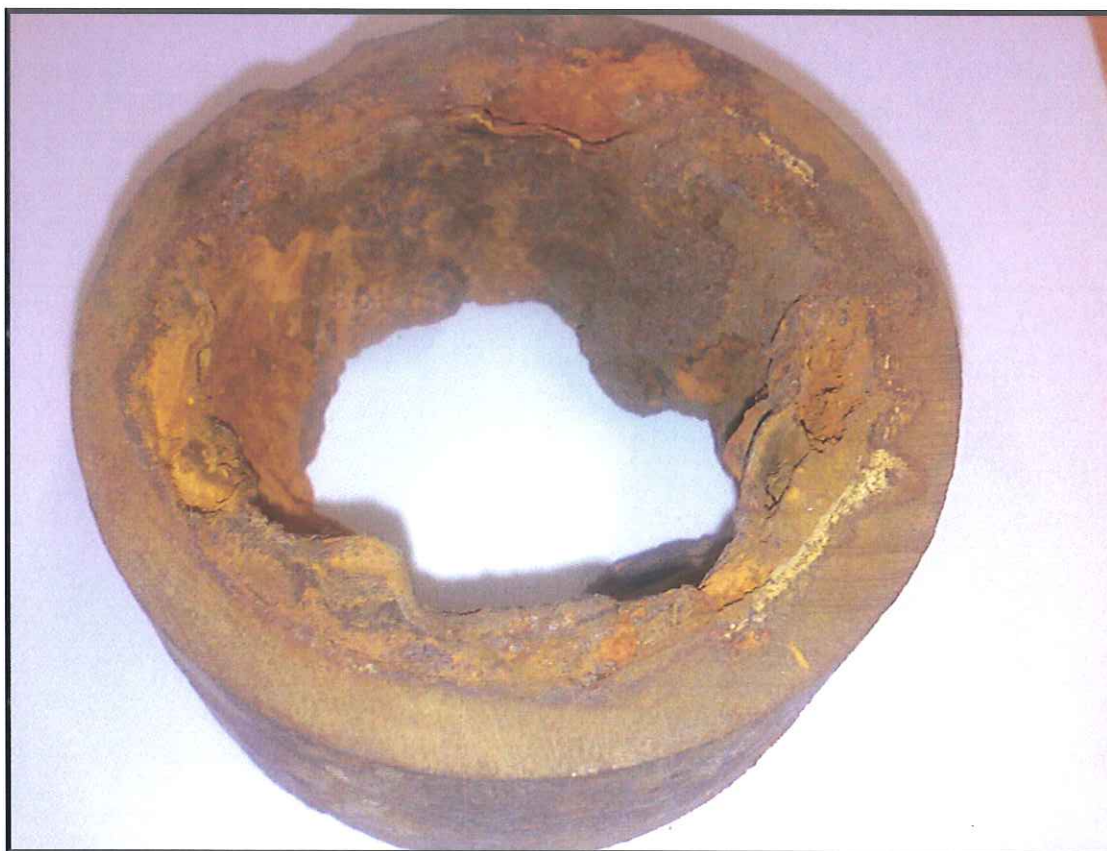
Obr. 6 - Usazeniny způsobují hydraulické ztráty v potrubí
