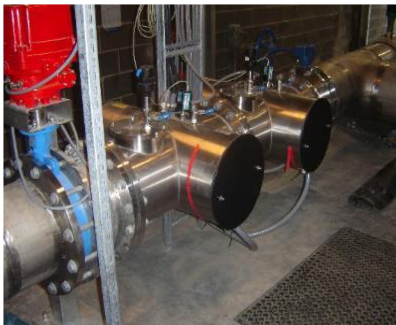
Obrázek 7: středotlakové zařízení v provozu
