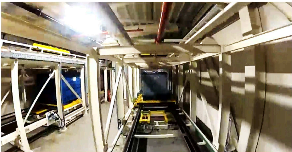
Obr. 2.5 Dopravníkový most se řetězovým dopravníkem
