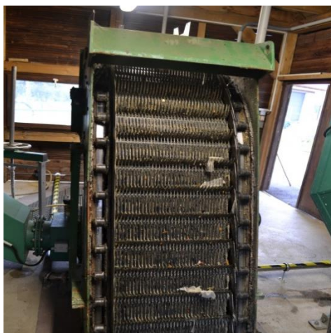
Obr. 6.3 - Automatické strojně stírané česle
