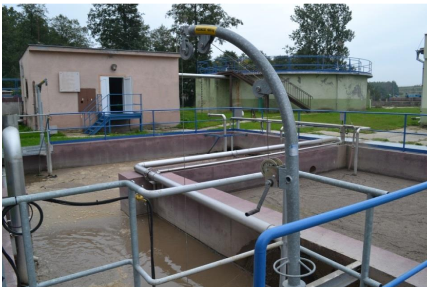
Obr. 6.6 - Pohled na objekt s denitrifikačními nádržemi DN1, DN2 a kalovým silem. V pozadí vlevo čerpací stanice, napravo nitrifikační nádrž N1
