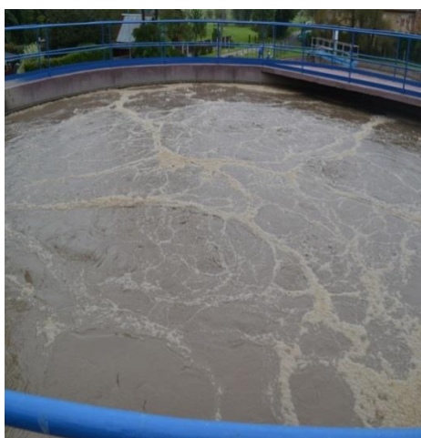
Obr. 6.7 - Nitrifikační nádrž N1
