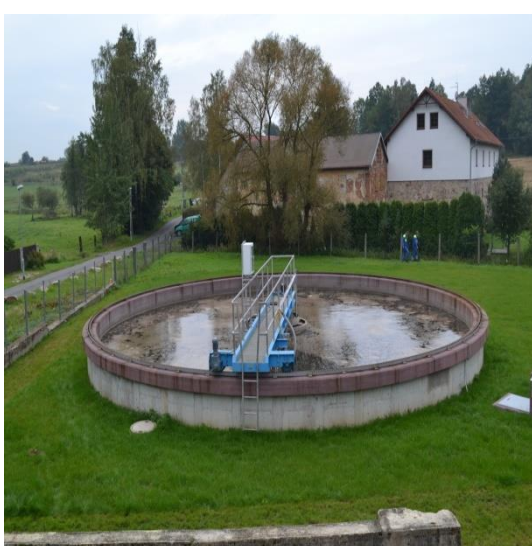
Obr. 6.9 – Pohled na dosazovací nádrž
