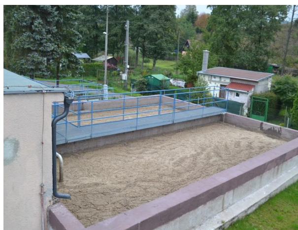
Obr. 6.8 - Nitrifikační nádrž N2
