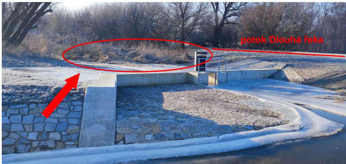
Obrázek 12 Znárodnění nedostatku u stavidla v Nedakonicích
