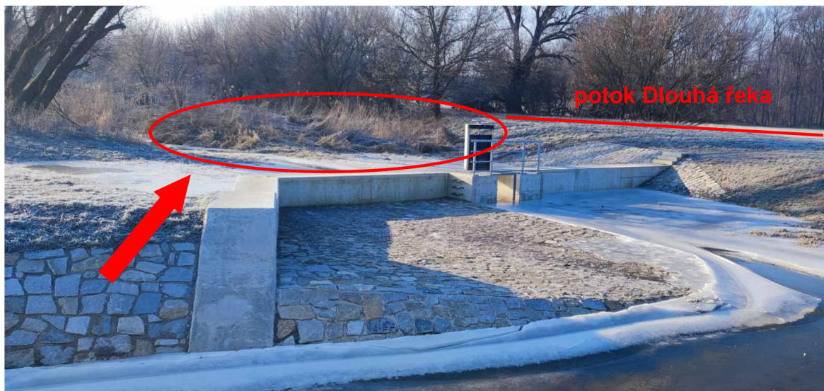
Obrázek 12 Znárodnění nedostatku u stavidla v Nedakonicích
