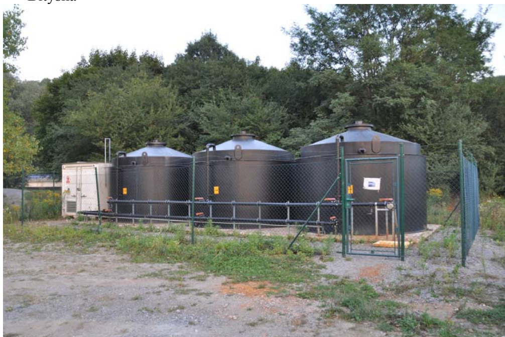
10. Fotografie dávkovacího zařízení síranu železitého \text{Fe}_2(\text{SO}_4)_3 pod obcí Veverská Bítýška
