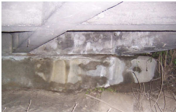
Obr. 2-4 Zatékání v oblasti krajních trámů [10]
