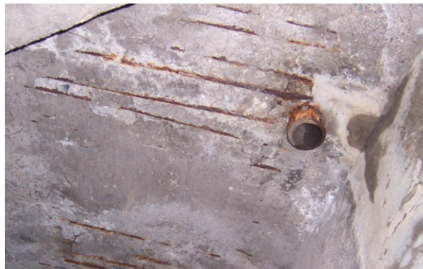
Obr. 2-3 Obnažená výztuž nosné konstrukce[10]
