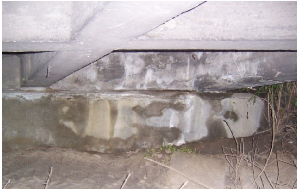
Obr. 2-4 Zatékání v oblasti krajních trámů [10]
