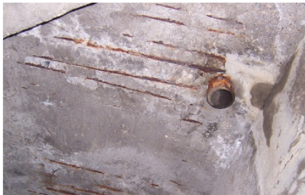
Obr. 2-3 Obnažená výztuž nosné konstrukce[10]
