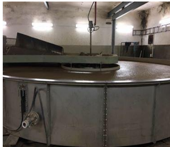
Figure 13: Flotation tank in JIP Větrní (Author 2020).
