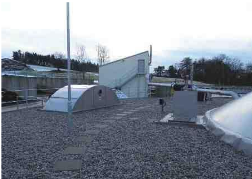
Obrázek 1: Bioplynová stanice před spuštěním
