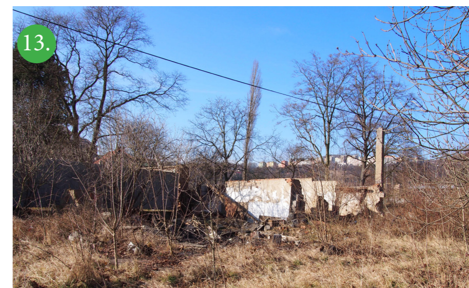
13. Poslední budova bývalého sportoviště, budova C na mapě současného stavu. K budově náleží asfaltová plocha cca 2 x 4 m. Všechny 3 budovy jsou ve špatném stavu a nepředpokládá se opětovné budoucí využití, proto je doporučeno jejich rozebrání.
