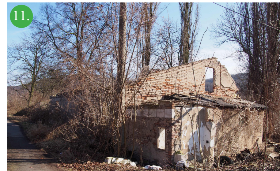
11. Budova A (viz mapa č 2.) u fotbalového hřiště. V současné době jsou budova značně zanedbána a zdevastována. Okolí budov je zaneseno odpady a samotné budovy slouží často jako úkryt lidem bez domova nebo narkomanům.
