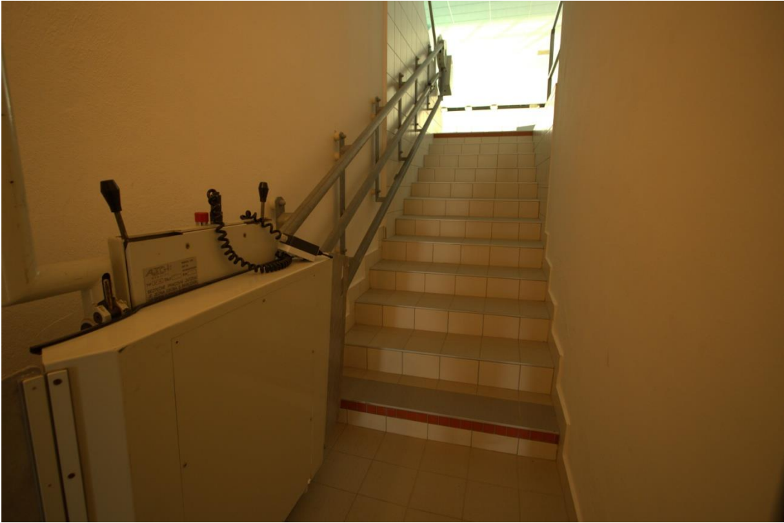
Obrázek 13. Schody k bazénu ze šatny invalidů
