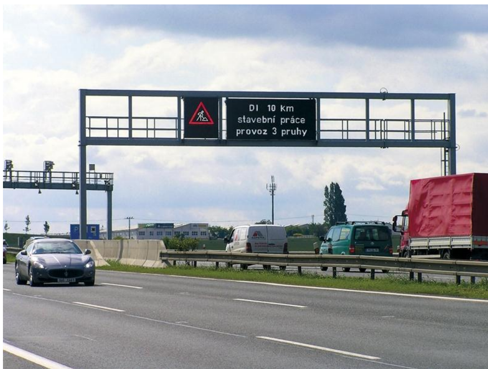
Obr.4 ZPI a PDZ na portřřlu nad vozovkou
