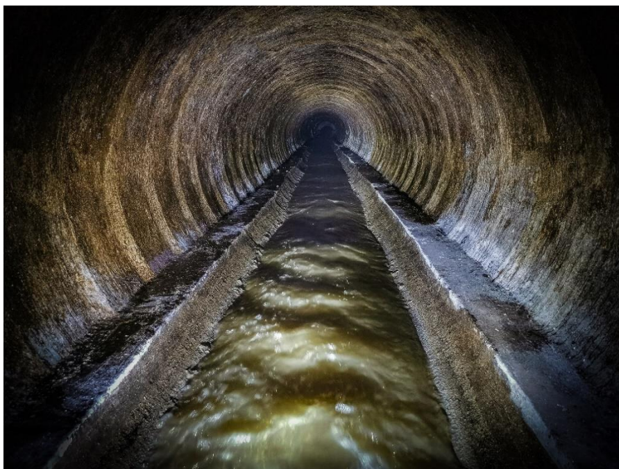
Obr. 3-8 – pohled na kanalizační sběrač C provedený nemechanizovaným štítem v Brně – Řečkovících [zdroj: Lukáš Havlíček]
