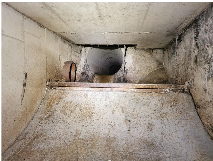
Obr. 4-27 – pohled na oddělovací komoru – vlevo je přítok z oddělovače na dešťové stoce – DN 400 kamenina [zdroj: Lukáš Havlíček]
