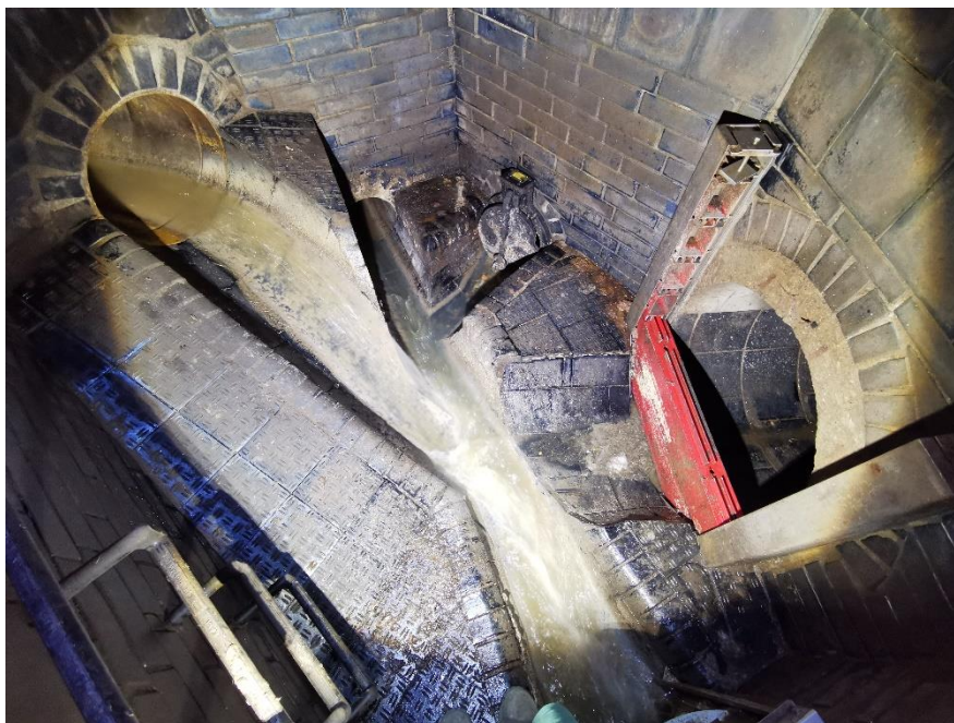
Obr. 4-30 – pohled na trojici nátoků, na přelivnou hranu z hradících prvků a na odlehčovací stoku [zdroj: Lukáš Havlíček]
