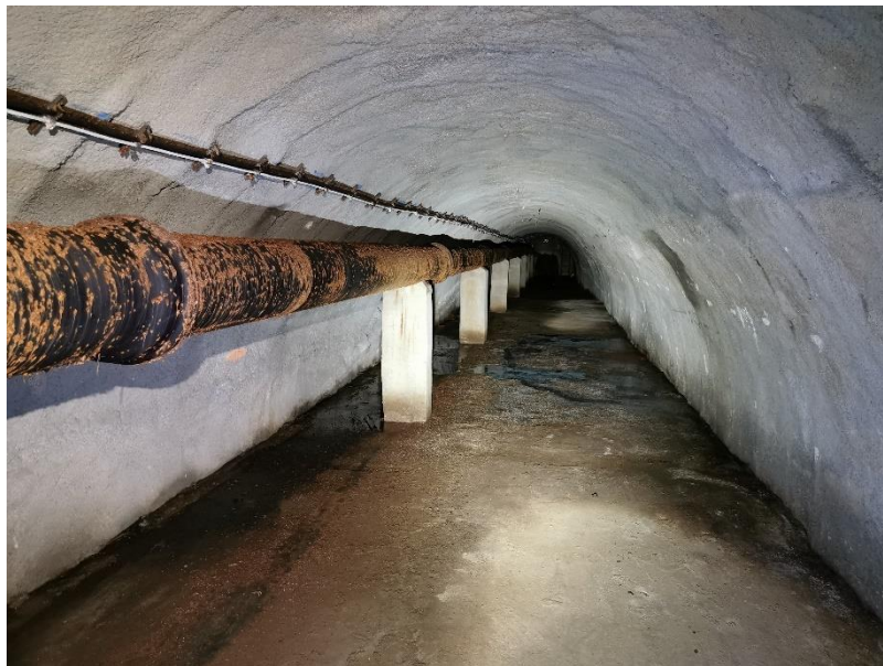
Obr. 3-6 – pohled na ostění ze stříkaného betonu – kanalizační štola Nové Spolí (Český Krumlov) [zdroj: Lukáš Havlíček]
