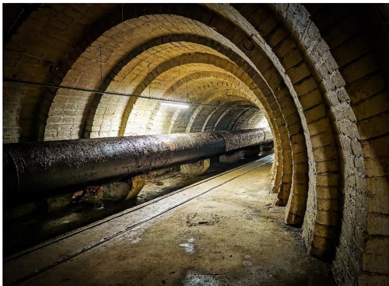
Obr. 3-4 – pohled na ostění z betonových tvárníc – vodovodní štola Radejčín [zdroj: Lukáš Havlíček]
