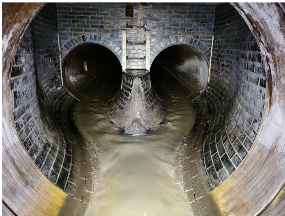
Obr. 5-25 – pohled na rozdělovací komoru stoky DN 1600 na 2x DN 1200 [zdroj: Lukáš Havlíček]
