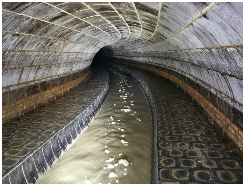
Obr. 4-4 – pohled na stávající tlakový profil (v současnosti slouží jako kmenová stoka F tekoucí opačným směrem) [zdroj: Lukáš Havlíček]
