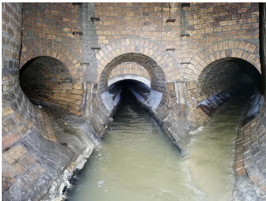
Obr. 5-19 – pohled na trojspojnou komoru nedaleko ulice Mladoboleslavská [zdroj: Lukáš Havlíček]
