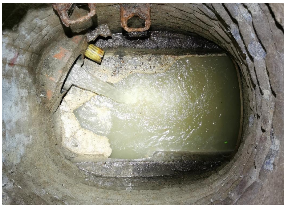
Obr. 5-10 – začátek profilu DN 800 nedaleko křižovatky ulic Tupolevova a Veselská [zdroj: Lukáš Havlíček]
