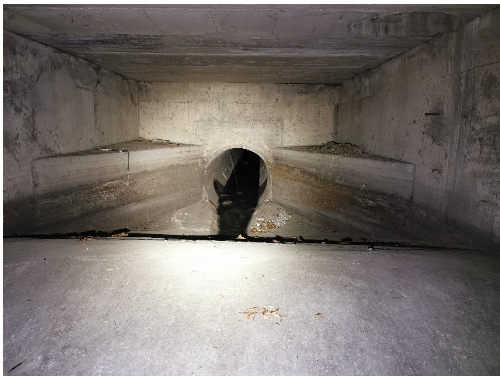
Obr. 4-12 – pohled do oddělovací komory kmenové stoky na ulici Mládežnická [zdroj: Lukáš Havlíček]
