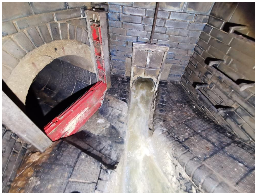
Obr. 4-31 – pohled na škrťící trat' se šoupětem a na odlehčovací stoku [zdroj: Lukáš Havlíček]
