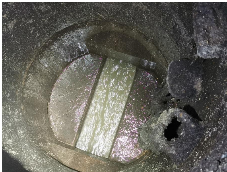
Obr. 5-23 – stoka těsně před ČOV [zdroj: Lukáš Havlíček]
