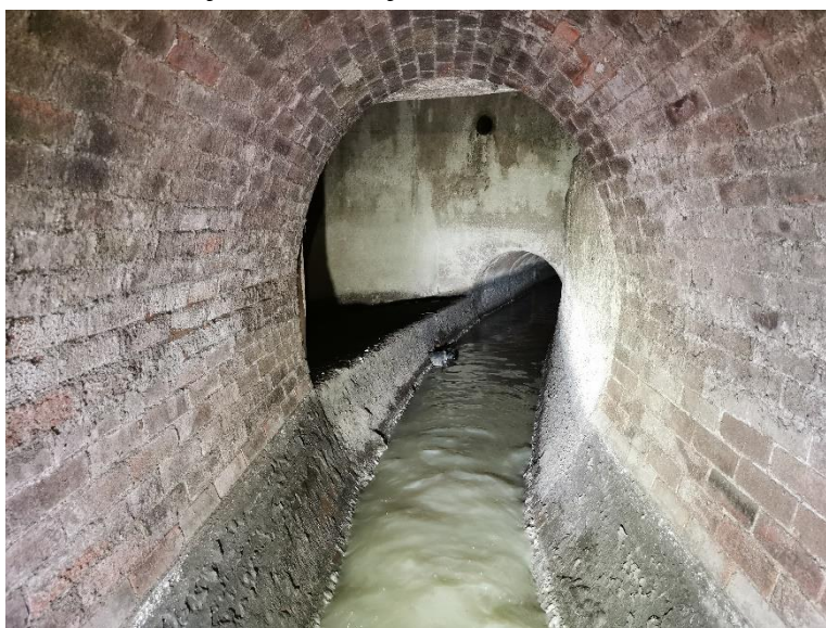
Obr. 4-8 – pohled z nátoky vejčité stoky zděné cihelné do oddělovací komory a na pokračující stoku ze železobetonových trub Vianini [zdroj: Lukáš Havlíček]
