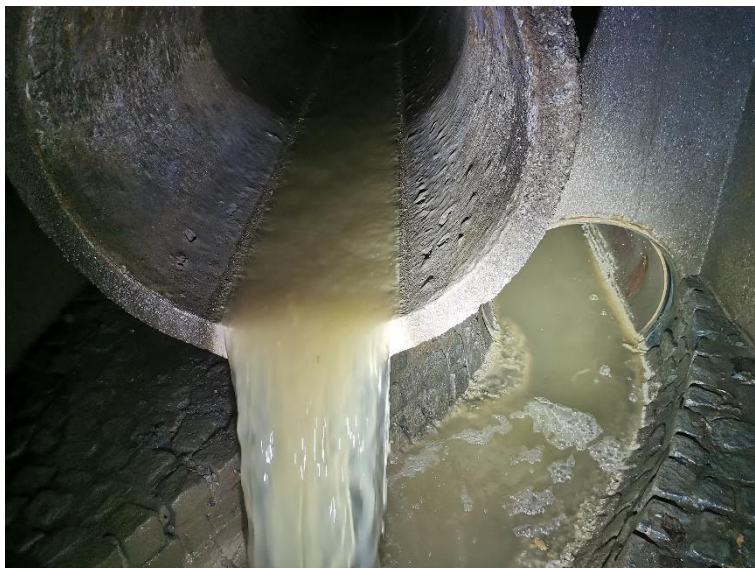
Obr. 4-13 - pohled na atypickou spojnou komoru stok DN 800 a DN 600 při ulici Velkoveská [zdroj: Lukáš Havlíček]
