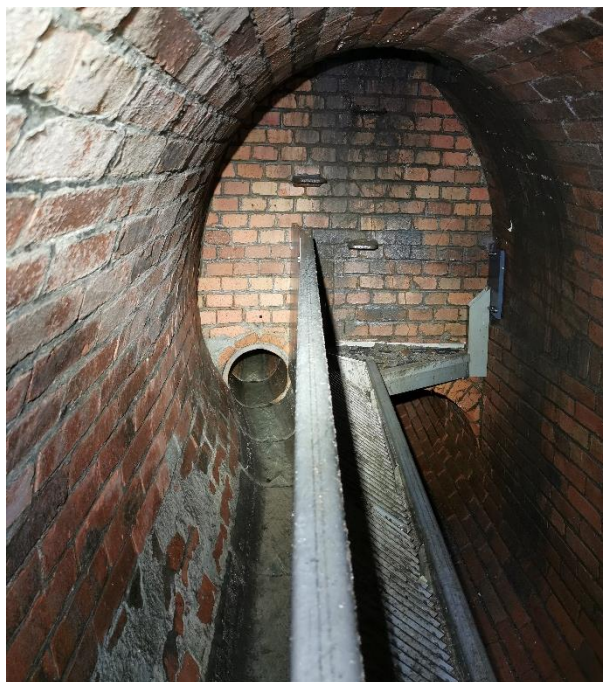
Obr. 4-33 – pohled na pokračující a odlehčovací stoku [zdroj: Lukáš Havlíček]
