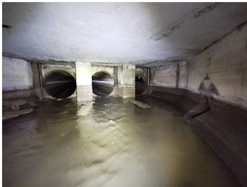
Obr. 5-26 – pohled na nátokovou komoru na ČOV [zdroj: Lukáš Havlíček]
