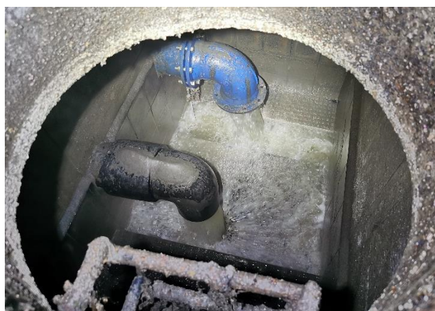
Obr. 5-22 – pohled na konec výtlaků čerpací stanice Štěpánovská [zdroj: Lukáš Havlíček]
