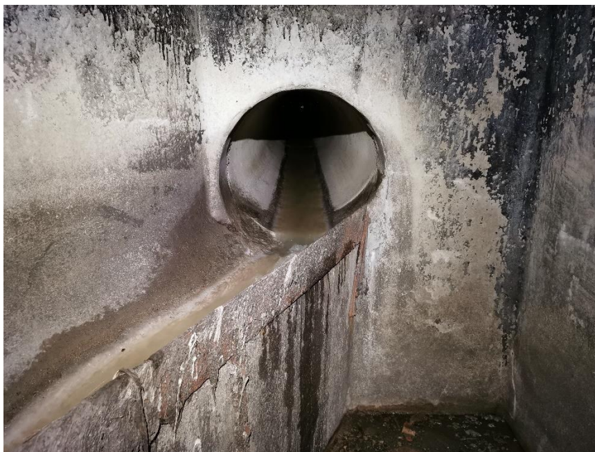
Obr. 4-23 – pohled do oddělovací komory – přeliv je tvořen mělkým žlábkem a plechovou hranou [zdroj: Lukáš Havlíček]
