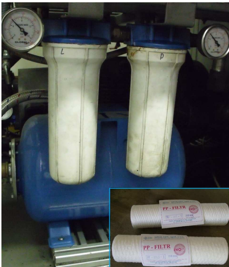
Obr. 5.2 Vodní filtry - umožňují recyklaci vody
