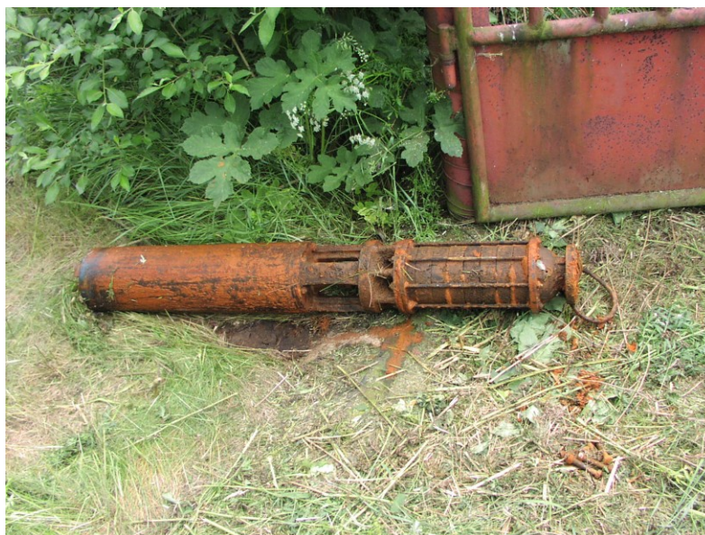
Obr. 4 - Demontované ponorné čerpadlo z vrtu HV-1
