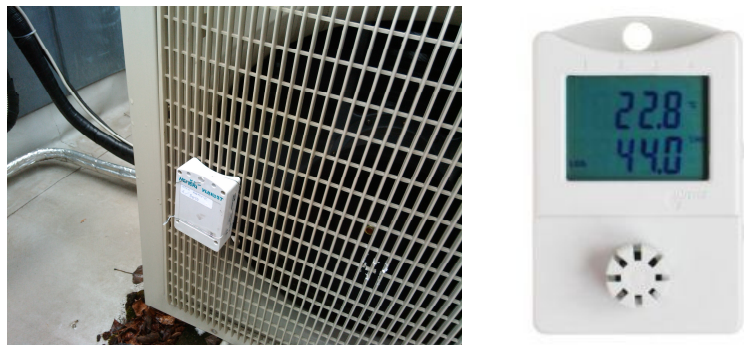
8.7 Datalogger [29] a jeho umístění na venkovní jednotce
