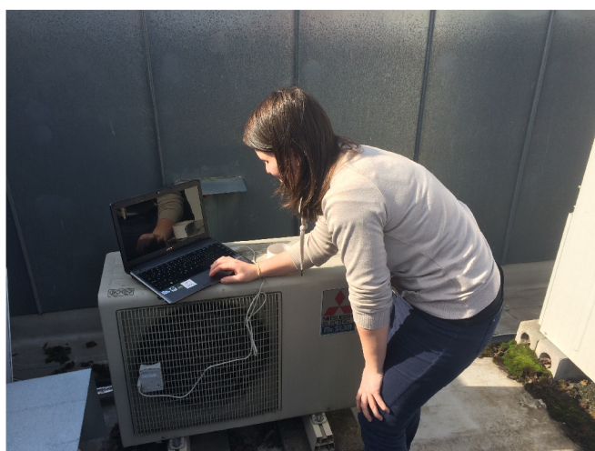
8.8 Stahování dat z dataloggeru
