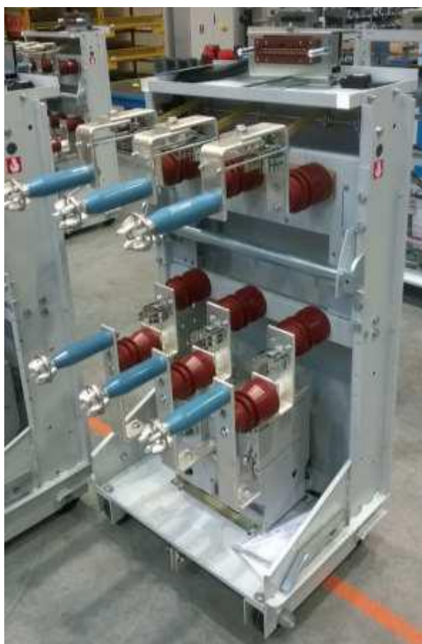
Obr. 29: Výsuvná časť SR12 so stykačom VSC7 – realizácia [autorské foto]
