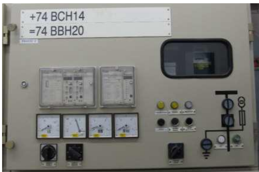
Obr. 19: Zmodernizovaná prístrojová skrinka rozvádzača SR [autorské foto]
