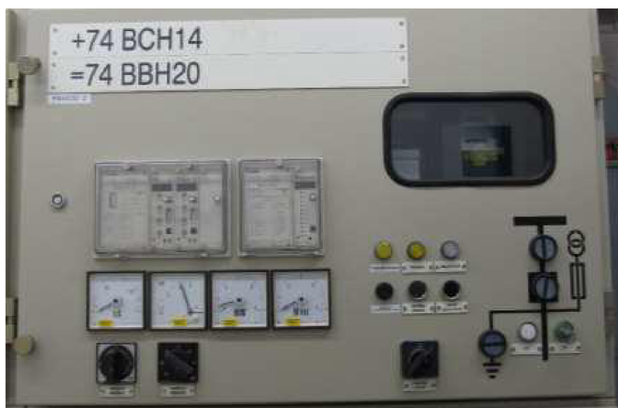
Obr. 19: Zmodernizovaná prístrojová skrinka rozvádzača SR [autorské foto]
