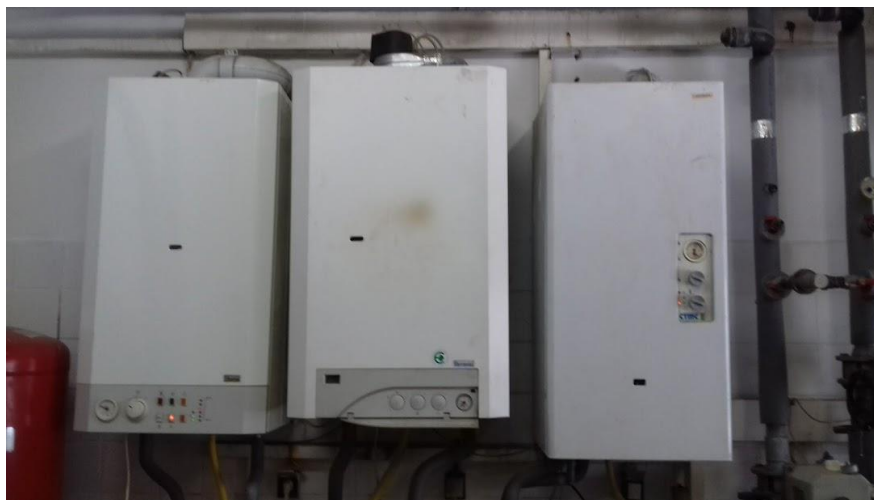
Obrázek 63. Tři plynové kotle zajišťující ohřev vody a vytápění pro halu na výrobu pomazánkového másla.
