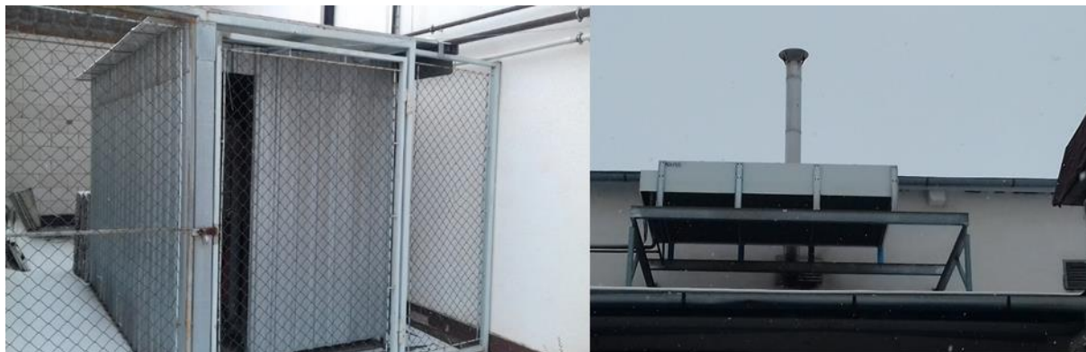
Obrázek 66. Kompresorová stanice s kondenzátorem.
