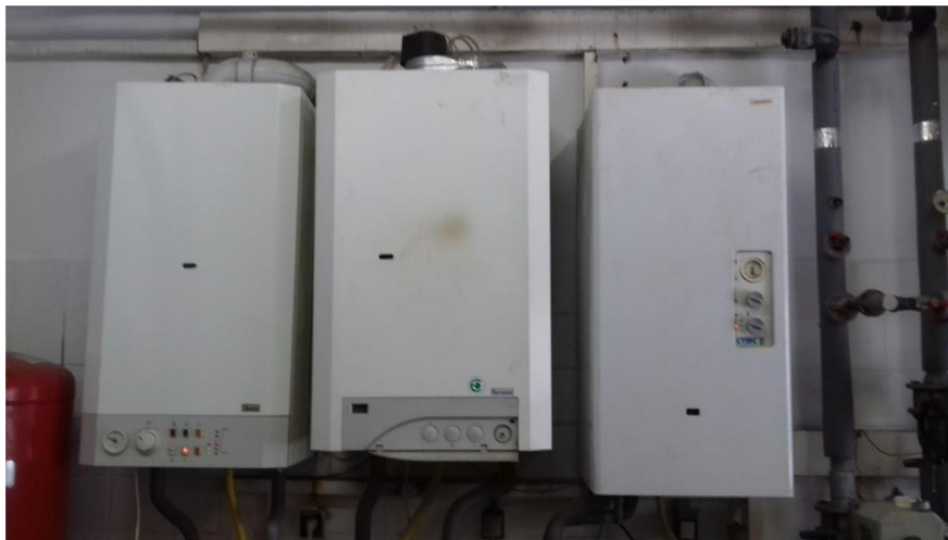
Obrázek 63. Tři plynové kotle zajišťující ohřev vody a vytápění pro halu na výrobu pomazánkového másla.
