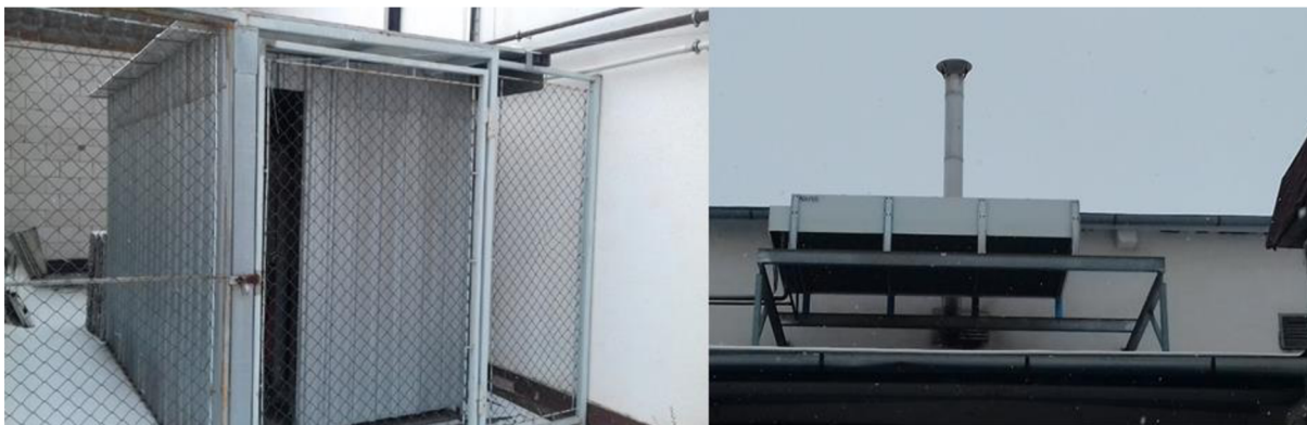
Obrázek 66. Kompresorová stanice s kondenzátorem.
