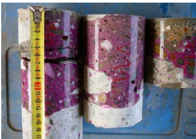
Obrázek 4 Zjištění míry karbonatace na odebraných vývrtech [18]
