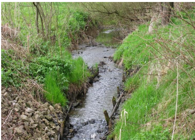
Foto 23: Degradující opevnění koryta a dna tzv. oplůtky, potok si hledá vlastní cestu. (Foto Václav Kahuda 2015).
