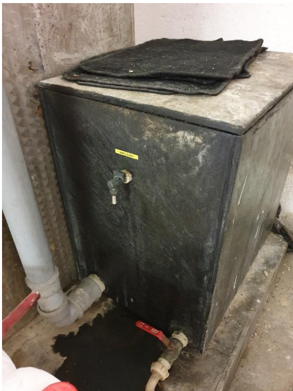
Příloha 5. Šachta s ventilem pro kontrolu vypouštěných odpadních vod
