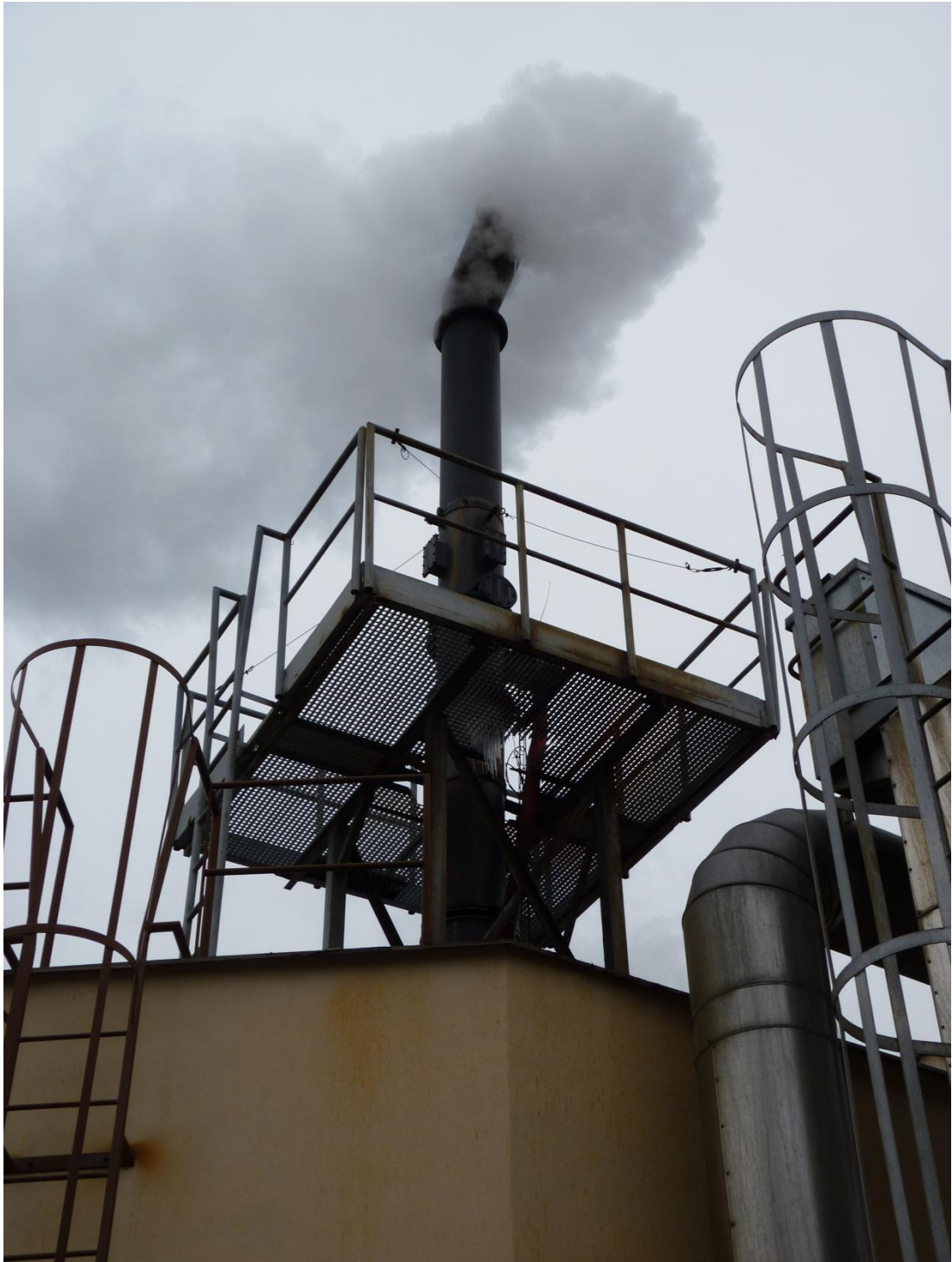
Fotografie č. 6 Komín vypouštějící vyčištěné spaliny do ovzduší (těsně před výstupem jsou čidla pro měření emisí)
