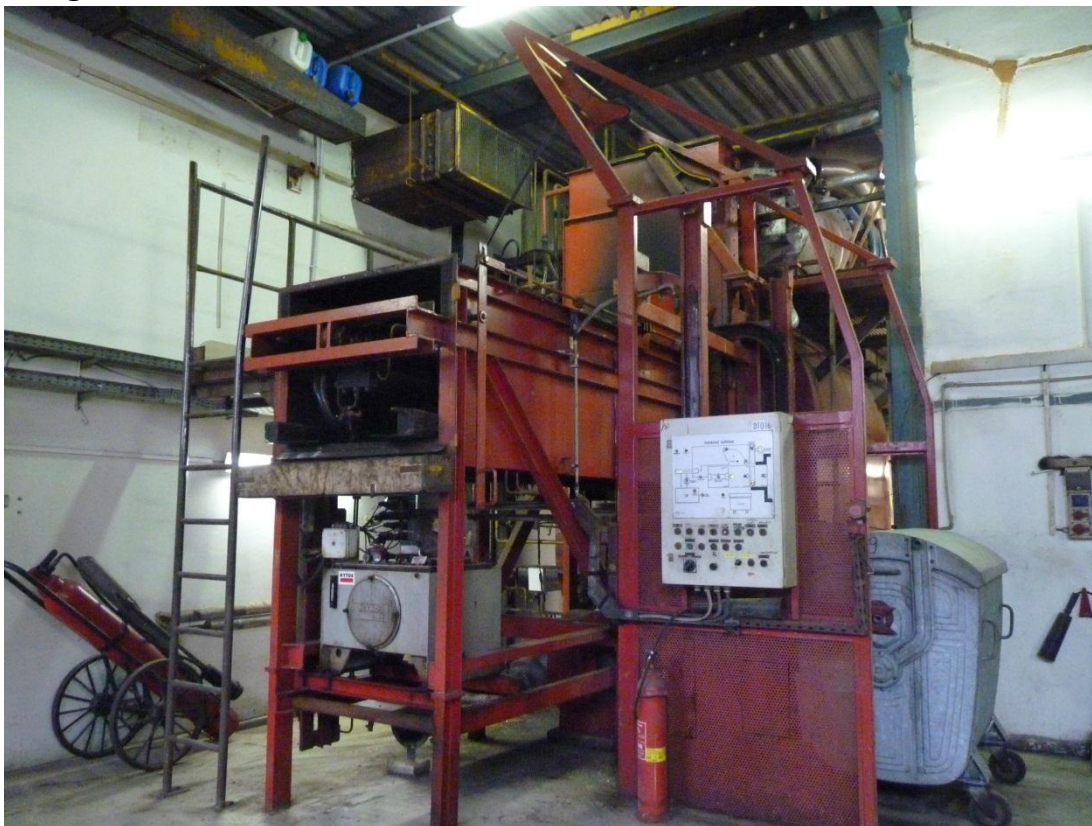
Fotografie č. 1 Podávací zařízení
