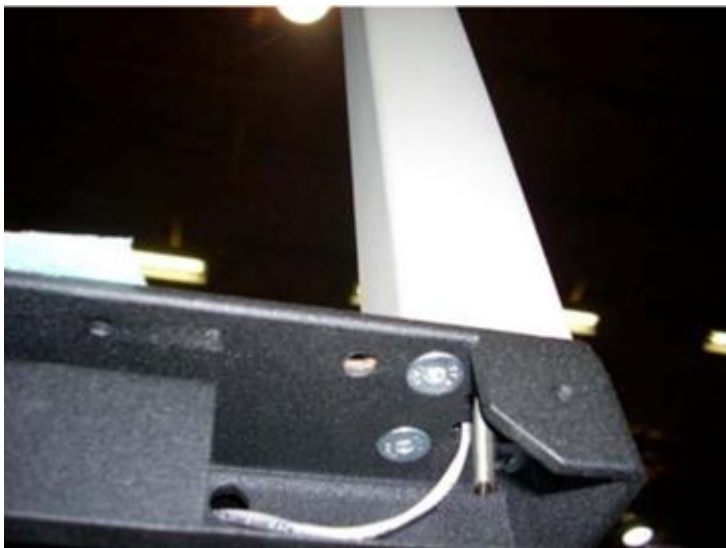
Obrázek 9 – kabeláž vedoucí ze sloupku se zámkem
