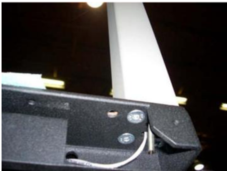
Obrázek 9 – kabeláž vedoucí ze sloupku se zámkem
