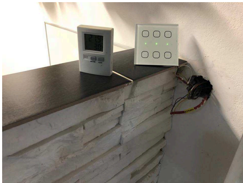
Obr. 3.4 Ovládání osvětlení showroom
