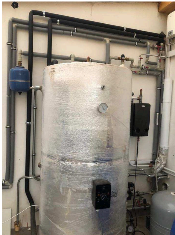
Obr. 3.6 Vodní nádrž showroom
